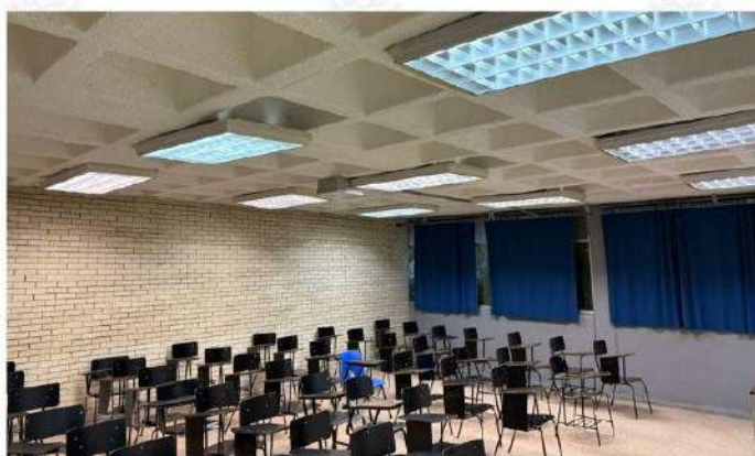
Luminaria en aulas
