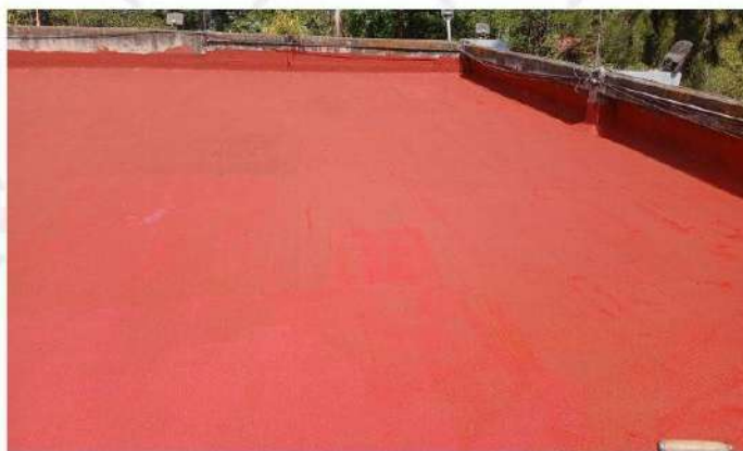
Impermeabilizante de A6
